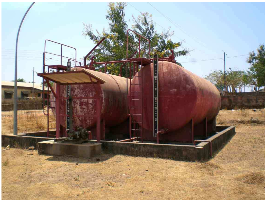
Les cuves pour le stockage de carburant
